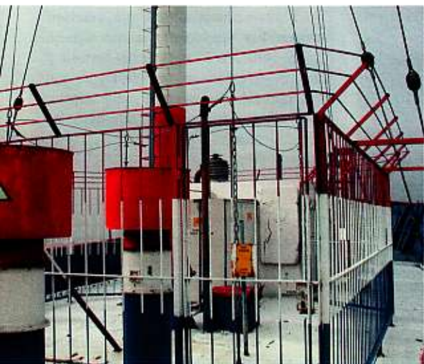
De nieuwe zendantenne voor gebruik in Lelystad is voorzien van een stevig hekwerk ter voorkoming van elektrocutie.
